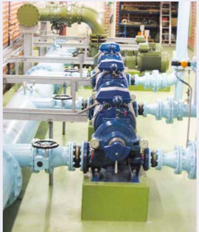
Energiebesparing en redundantie door parallelbedrijf
