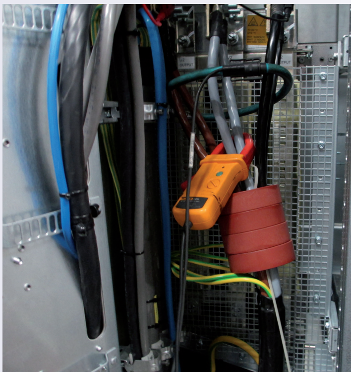
Figuur 1. Common mode filter, vier ferrietkernen en twee parallelle kabels
